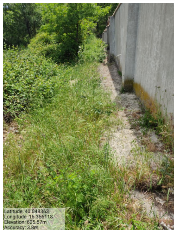
Int. _1.1.4_ Fascie Loc. Cimitero - Foto 1
