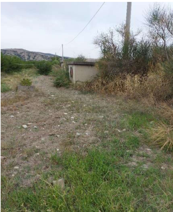
Pozzetti di linea esistenti da fare manutenzione
