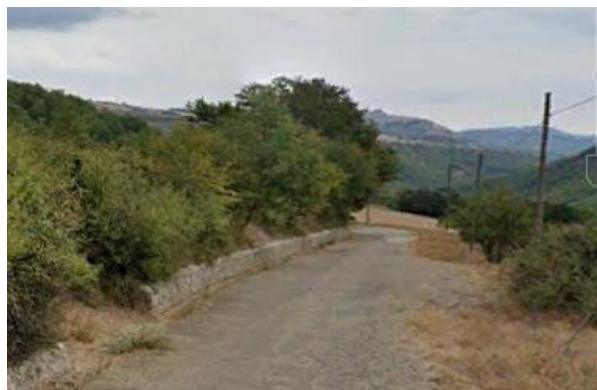
Int.6.3.6.1+6.3.6.2- Strada Casinale foto n°1
