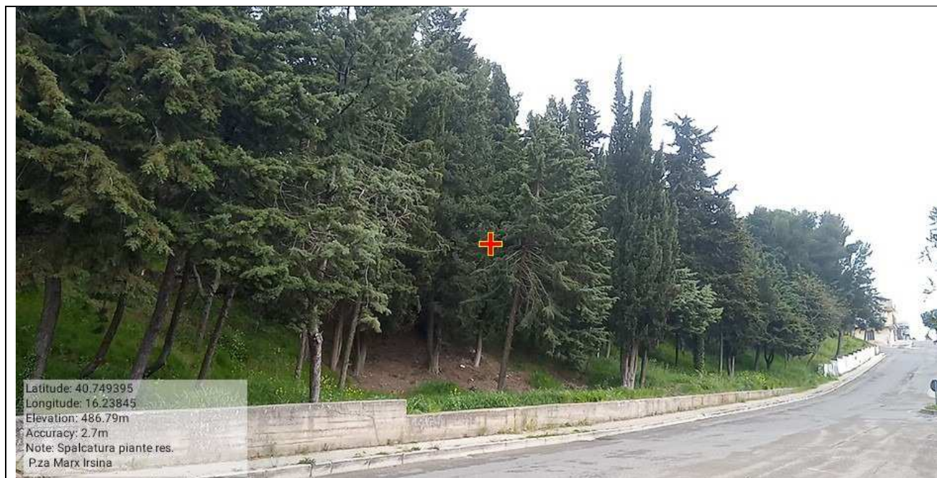
Int. 5.3.4 Spalcatura eseguita su piante resinose . Piazza carlo Marx Irsina - Foto N°39
