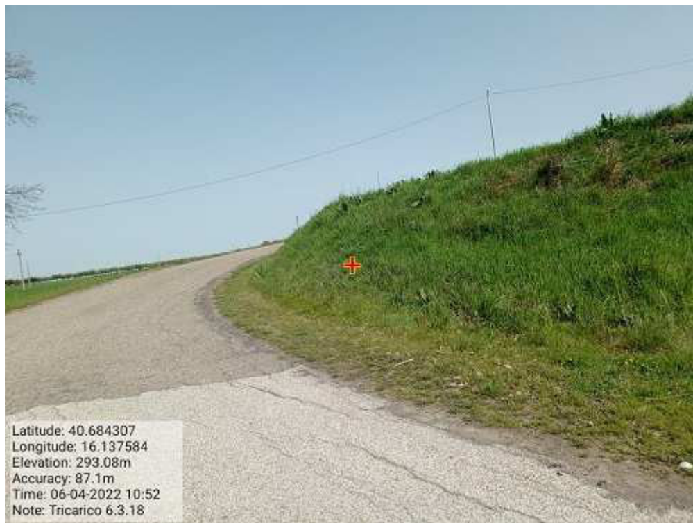
INTERVENTO 6.3.18.- TRICARICO STRADA COMUNALE FORTE ORLANDO FG.4
