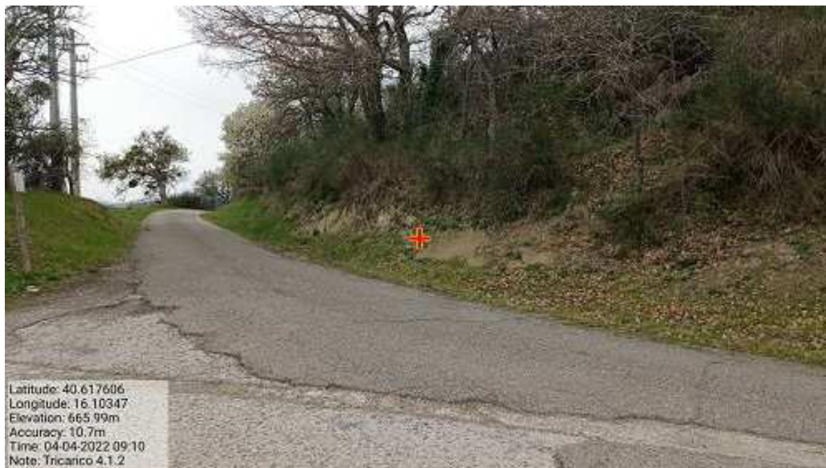
INT. 4.1.2 - TRICARICO STRADA VALLE RIFUGIO-MANTENERA Fg. 62 part:81-28-42-87-80-271-141 Foto n.25
