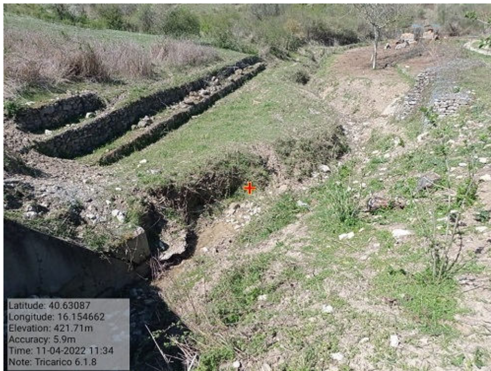
INTERVENTO 6.1.8- TRICARICO Fig. 61 PARTE ACQUA VALLONE CASTAGNONE (AFFLUENTE) Foto n. 40
