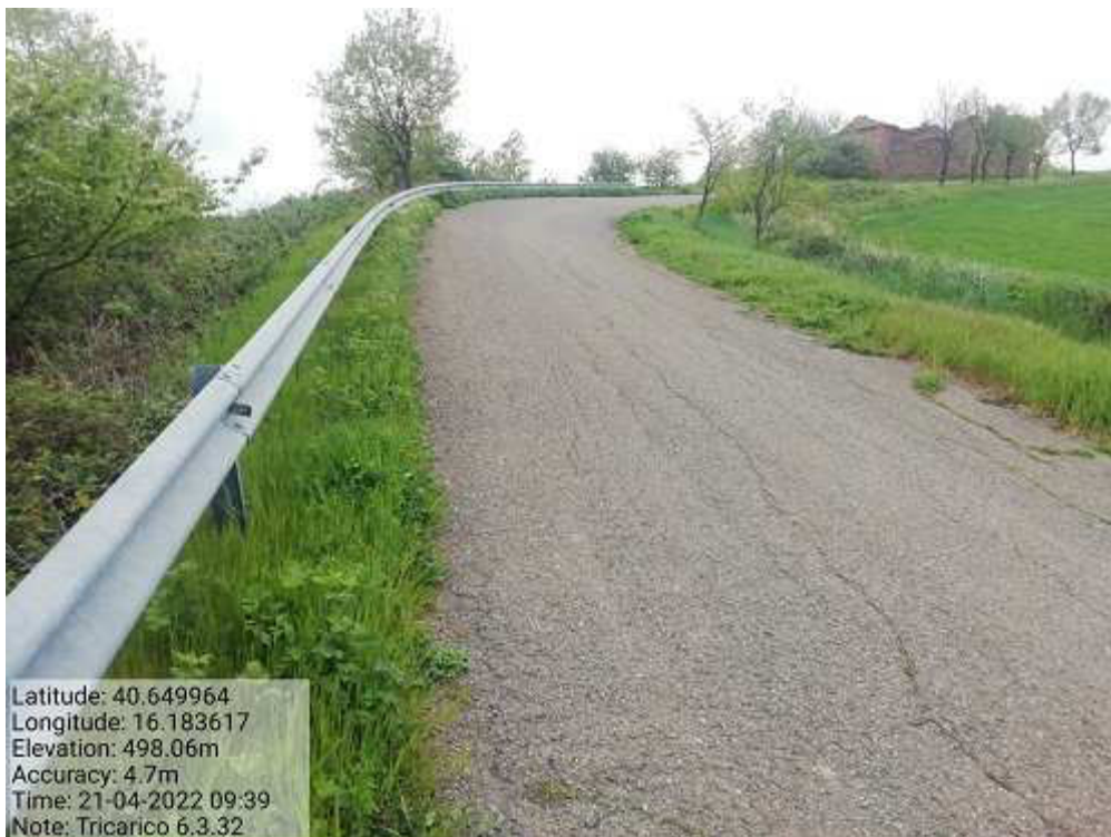
INTERVENTO 6.3.32- TRICARICO STRADA COMUNALE CACCIA NELLA NEBBIA FG.55-56-37-38-48-15 Foto n. 60
