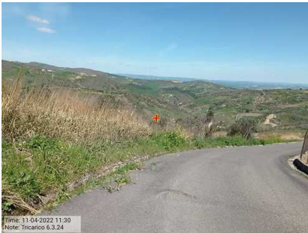
INTERVENTO 6.3.24.- TRICARICO STRADA COMUNALE CASTAGNONE FG.61-48-37 Foto n. 66
