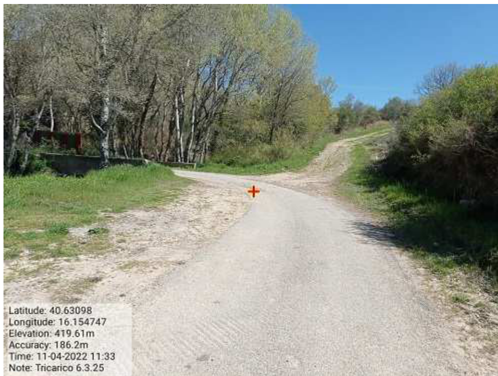
INTERVENTO 6.3.25 - TRICARICO STRADA COMUNALE CASTAGNONE 2 FG.61-48-37 Foto n. 67
