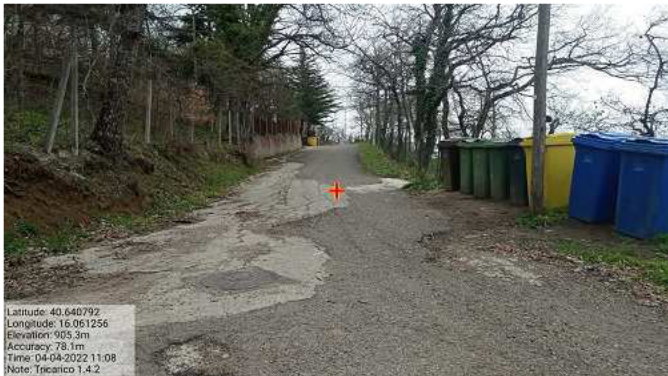
INTERVENTO 1.4.2 TRICARICO Fg.42 part.242 Loc.Trecancelli (strada interna trecancelli diramazione) Foto n.17
