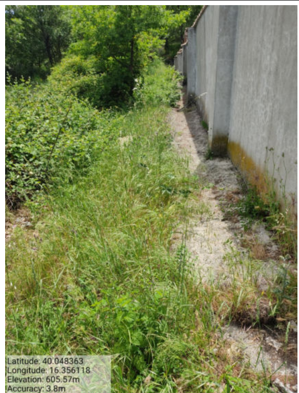
Int. _1.1.4_ Fascie Loc. Cimitero - Foto 1
