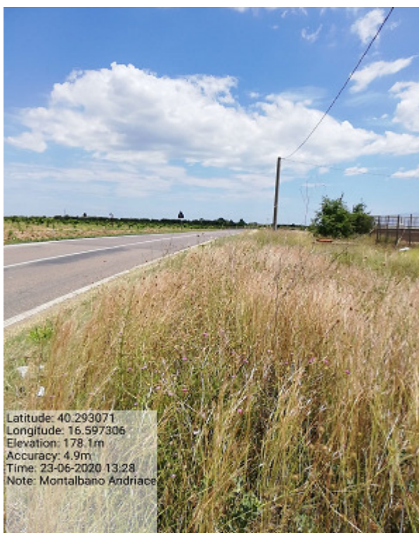
Int.5.2.1 S.P 154 Montalbano –Andriace Manutenzione della viabilità pulizia cunette
