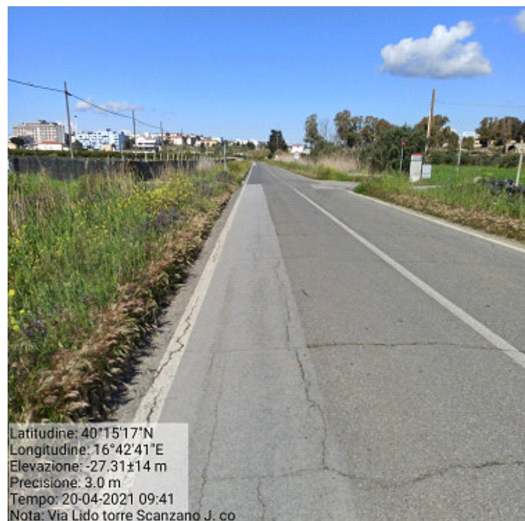
Int.5.1.2 Loc. Via Lido torre Manutenzione Viabilità Comunale e Provinciale
