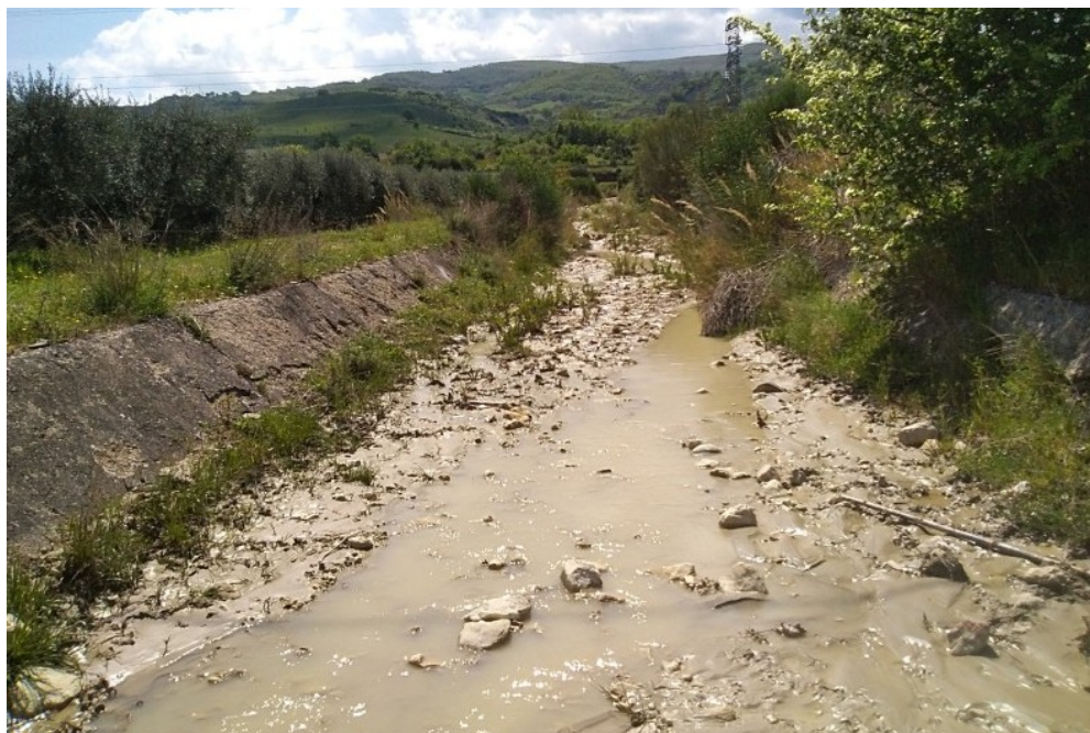
Intervento 4.1.7 - LOC : Calciano zona Pantano - Salicara - decr: ripristino ufficio. idraulica Lat 40.59901 Lon16.21000
