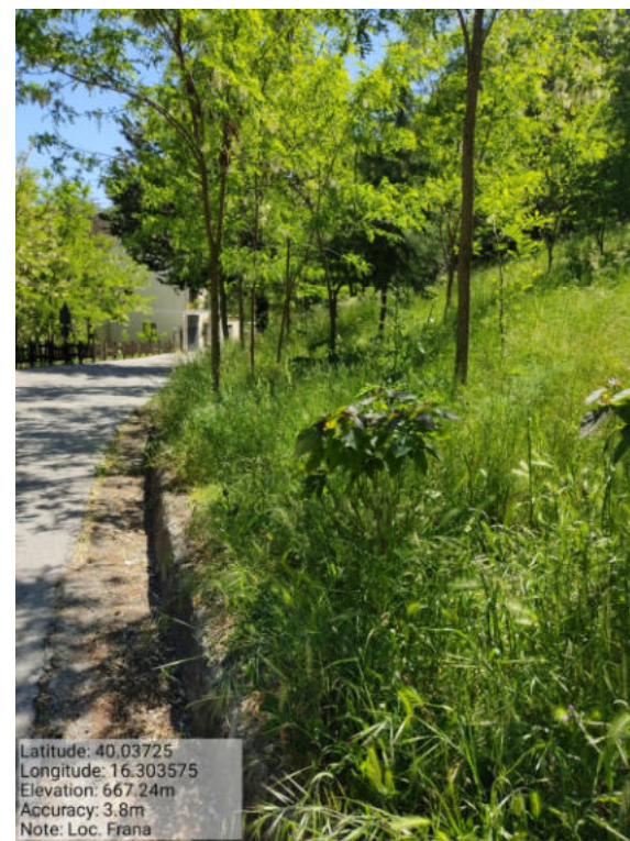
Int. _1.1.4_ Fascie Loc. Frana - Foto 1
