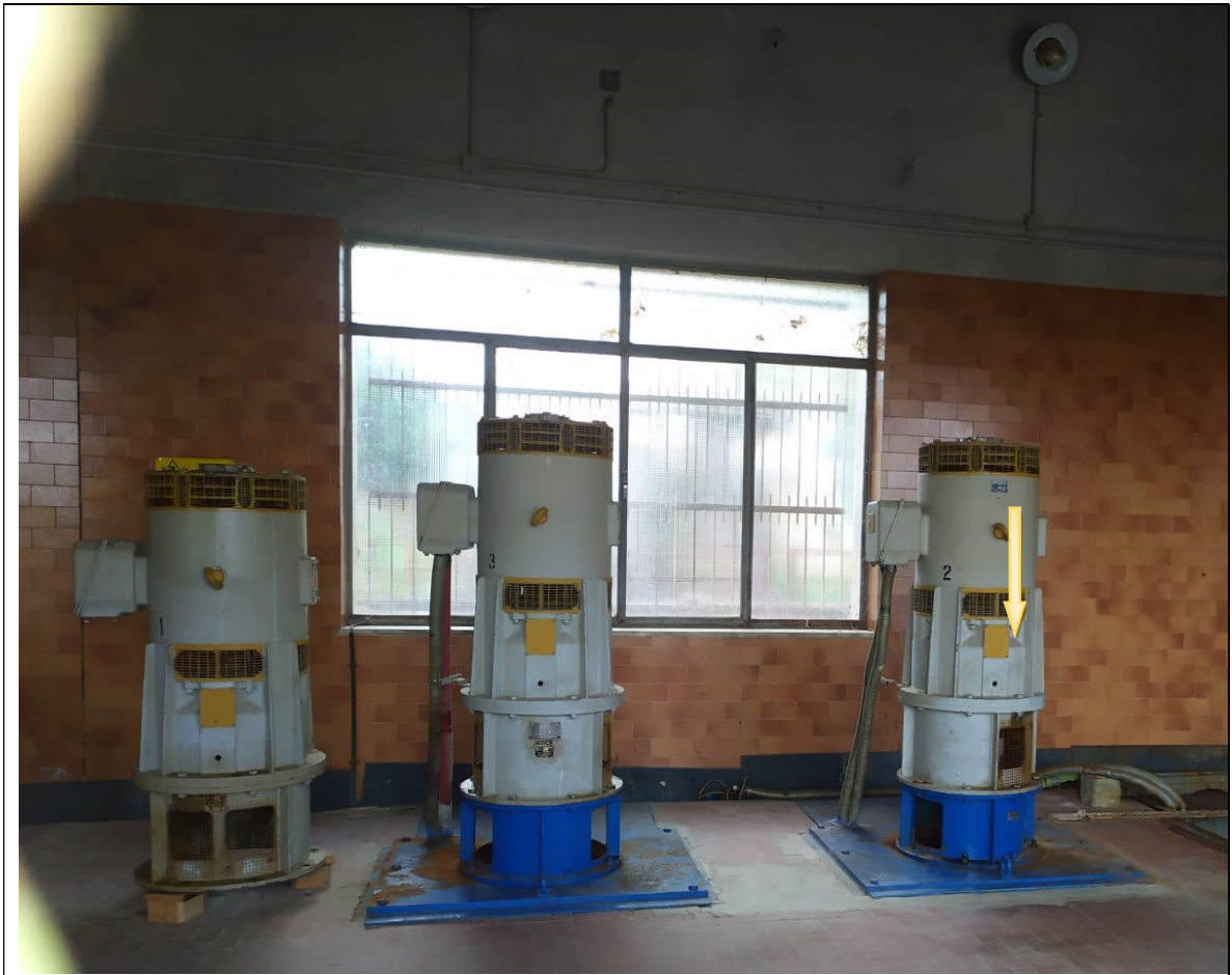
Foto 2) Punto di installazione gruppo pompa
