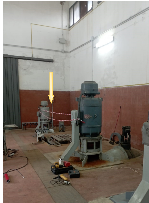
Foto 2) Punto di installazione E.P.
