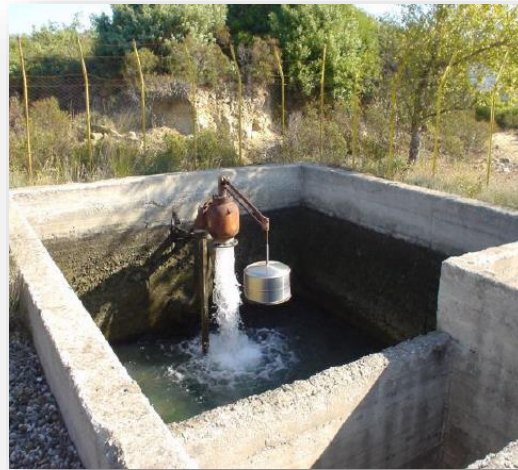
Fig. 8 - Vasca di carico "Monte Cotugno"
