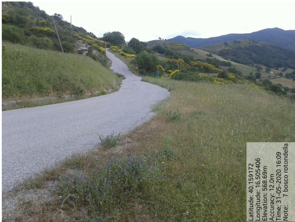
Int.6.1./2 Strada Comunale Bosco - Foto 9 Canalette
