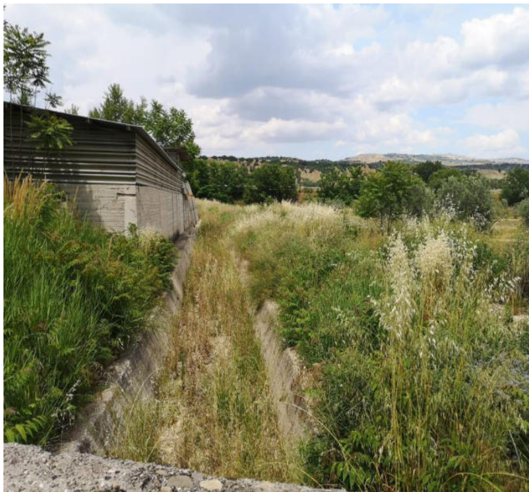
Int. 1.2.1 Loc.Istituto professionale – scalo Garaguso ; MANUTENZIONE DI VIALE TAGLIAFUOCO Coordinate geo. 40.594379N 16.236804E
