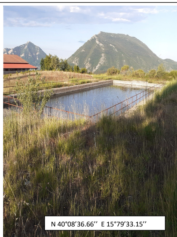
int. 6.1 - Foto 1 – vasca di accumulo Roccazzo
