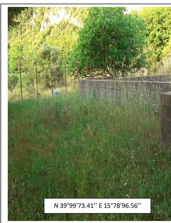
Int.6.1.2 - Foto 1 – vasca di accumulo Piano dei Peri
