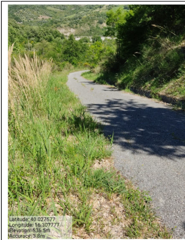
Int. _6.3_Manutenzione Strade Foto 1
