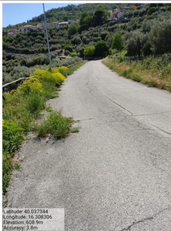
Int. _6.3_Manutenzione Strade Foto 2
