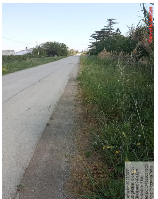
Int. 6.3.8.1 Via Trento Decesp. scarpate stradali
