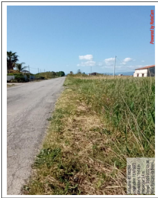
Int.6.3.14.1 Via Bellini Decesp scarpate stradali
