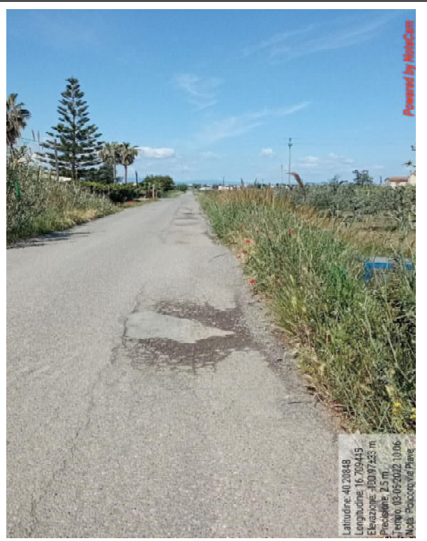
Int.6.3.12.1 Via Piave Decesp. scarpate stradali
