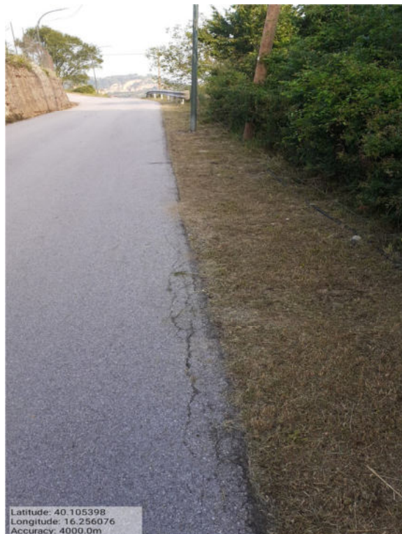
Int. _6.3._Manutenzione Strade Foto 2
