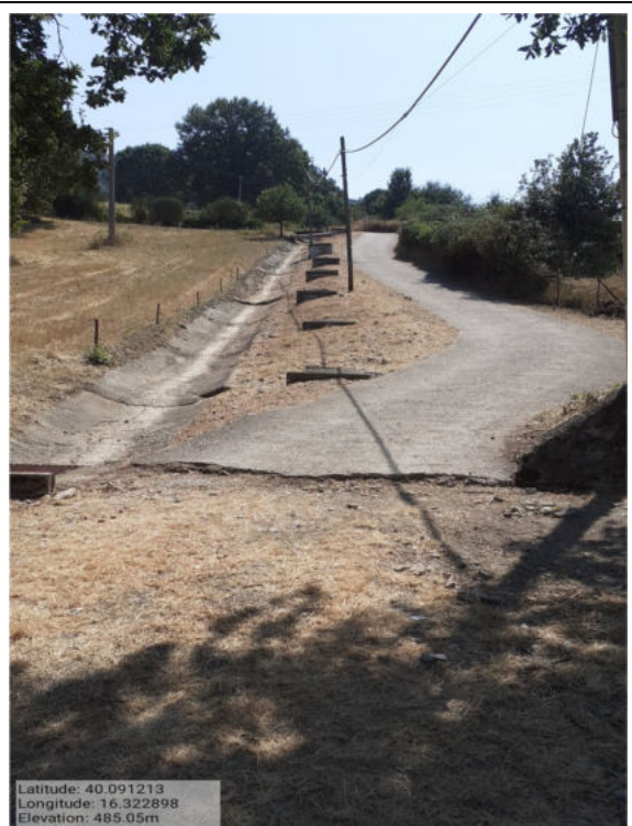
Int. _6.3._Manutenzione Strade Foto 4
