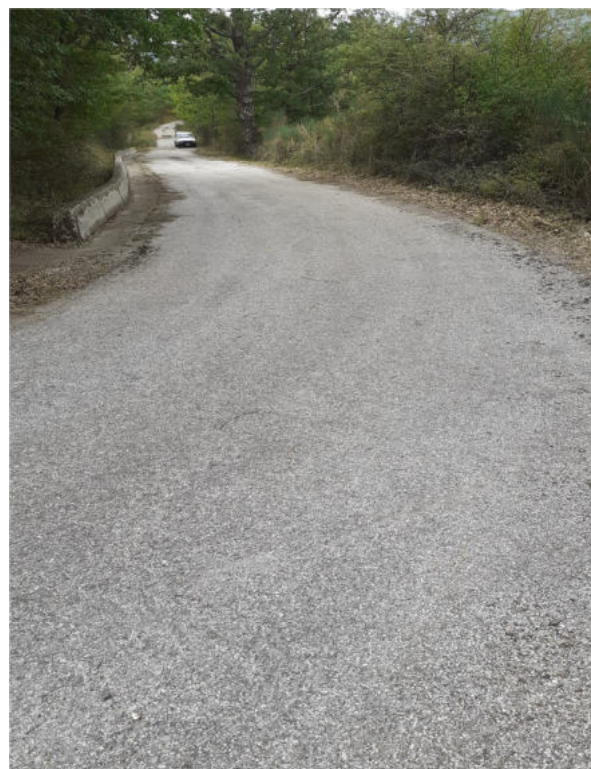
Int. _6.3_Manutenzione Strade Foto 4
