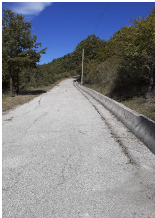
Int. _6.3_Manutenzione Strade Foto 3
