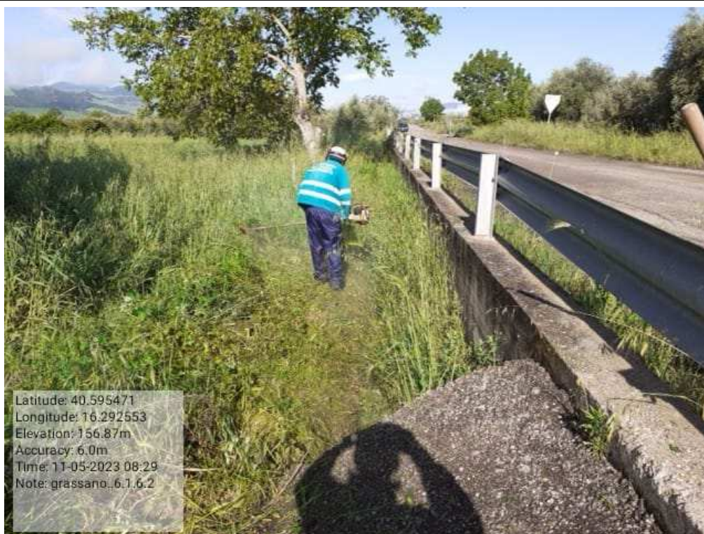
INTERVENTO 6.1.6.2. Grassano Fg.28-29-26-30-31 Canaletta Irrigazione - Distribuzione Principale Distretto 3 (tratto A) DURANTE Foto n. 46
