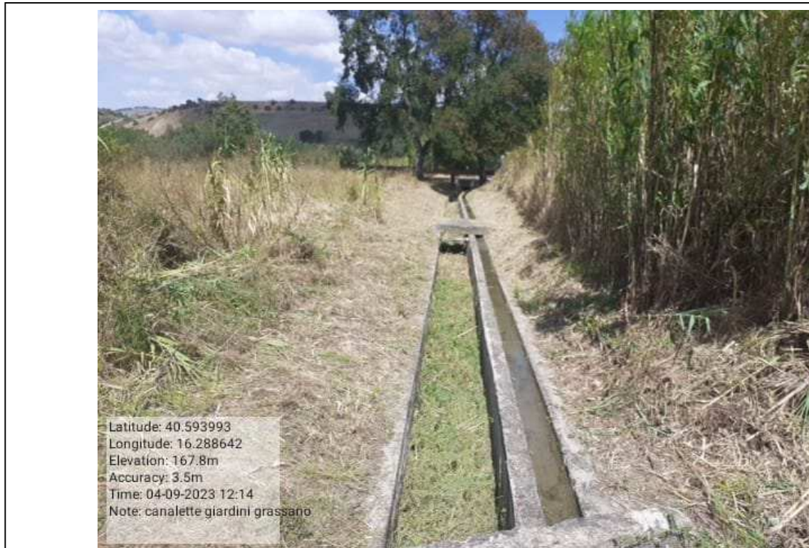
INTERVENTO 6.1.8.2 Grassano Fg.26-30 Canaletta Irrigazione - Distribuzione Principale Distretto 3 (tratto B) DOPO - Foto n. 52
