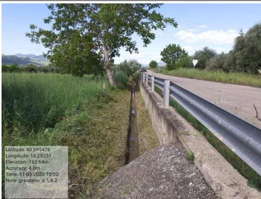
INTERVENTO 6.1.6.2. Grassano Fg.28-29-26-30-31 Canaletta Irrigazione - Distribuzione Principale Distretto 3 (tratto A) DOPO Foto n. 47
