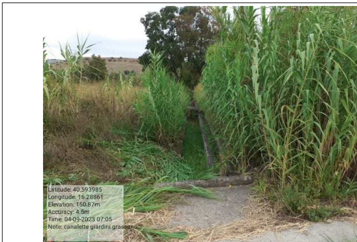
INTERVENTO 6.1.8.2 Grassano Fg.26-30 Canaletta Irrigazione - Distribuzione Principale Distretto 3 (tratto B) DURANTE Foto n. 51
