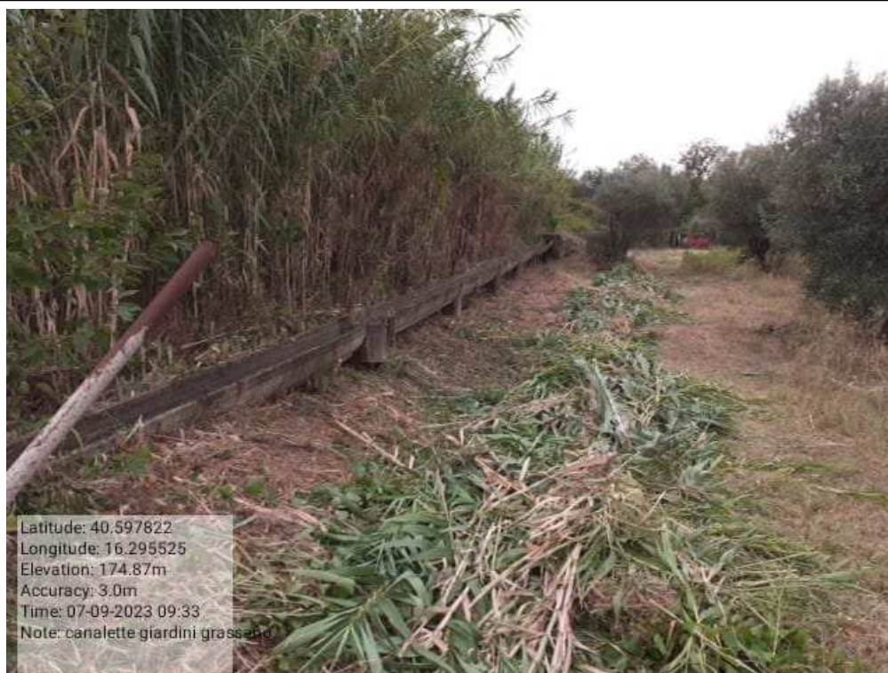
INTERVENTO 6.1.7.2 Grassano Fg.31 Canaletta Irrigazione - Distribuzione Principale Distretto 3 (tratto B) DURANTE Foto n. 48
