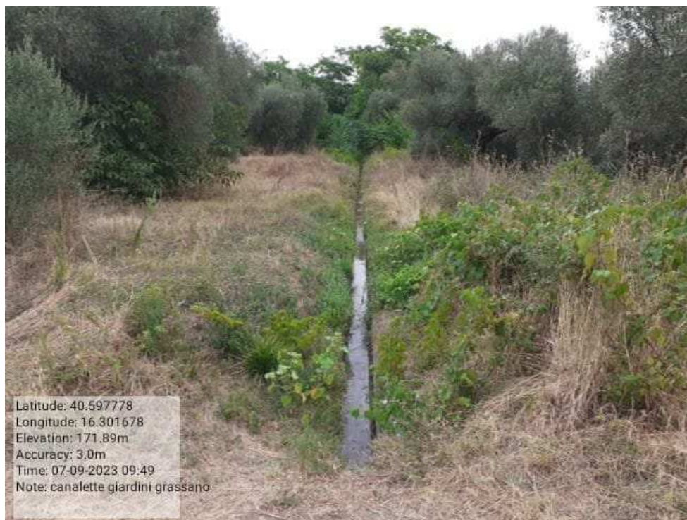
INTERVENTO 6.1.7.2 Grassano Fg.31 Canaletta Irrigazione - Distribuzione Principale Distretto 3 (tratto B) PRIMA Foto n. 48
