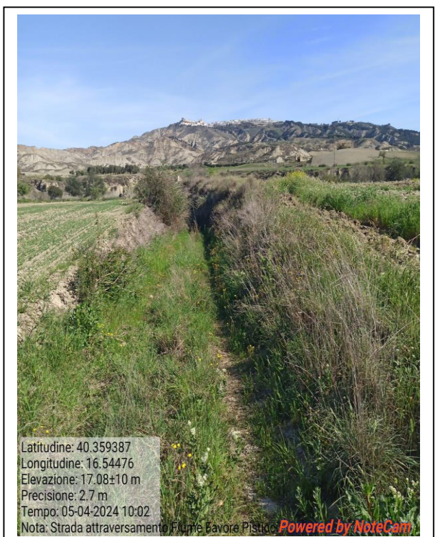
Int.6.3.15 Strada Comunale Cavone Decesp. scarpate stradali
