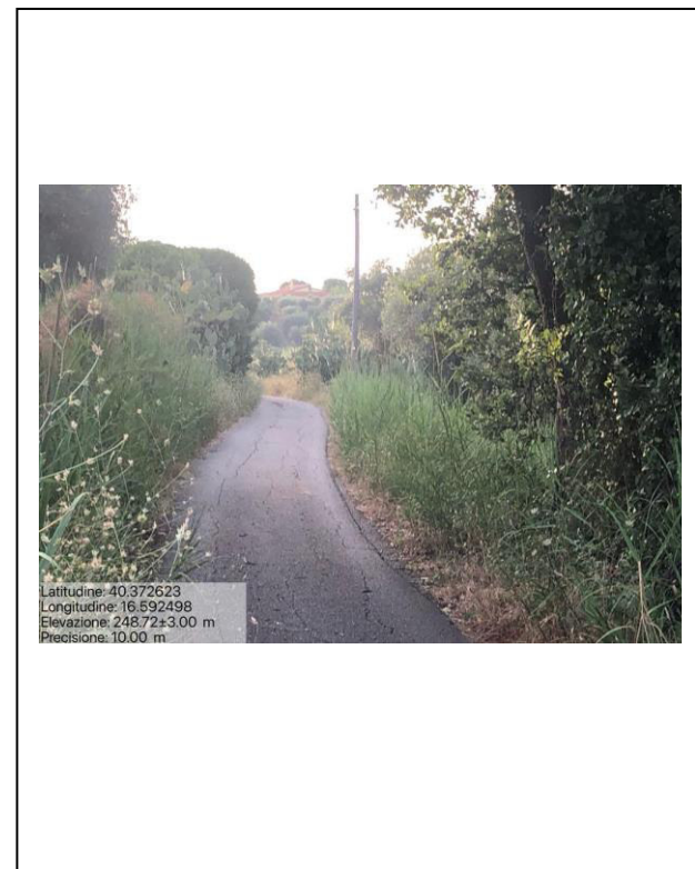
Int. 6.3.14 Strada c.da San Pietro F. Decesp. scarpate stradali
