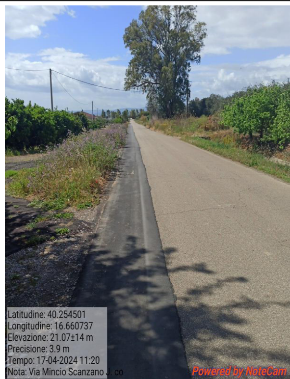
Int.6.3.1.1 Via Mincio-S.S. 598 Decesp. scarpate stradali
