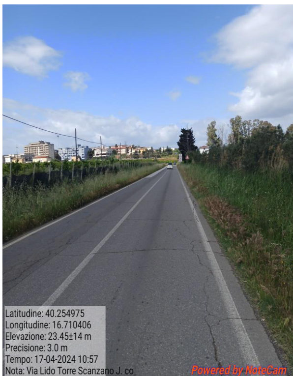
Int.6.3.4.1 Via Lido Torre Decesp. scarpate stradali
