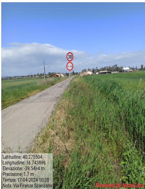
Int.6.3.12.1 Via Firenze Decesp. scarpate stradali
