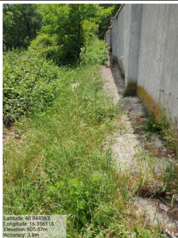
Int. _1.1.3_ Fascie Loc. Cimitero - Foto 1
