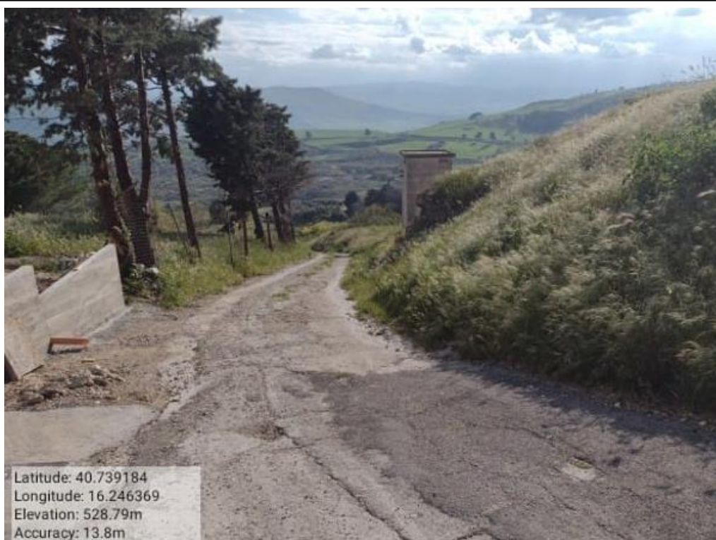
Int. -6.3.5.1 - 6.3.5.2 Irsina Foglio 44 - 57- 58 Strada Comunale Cimitero Foto N.46
