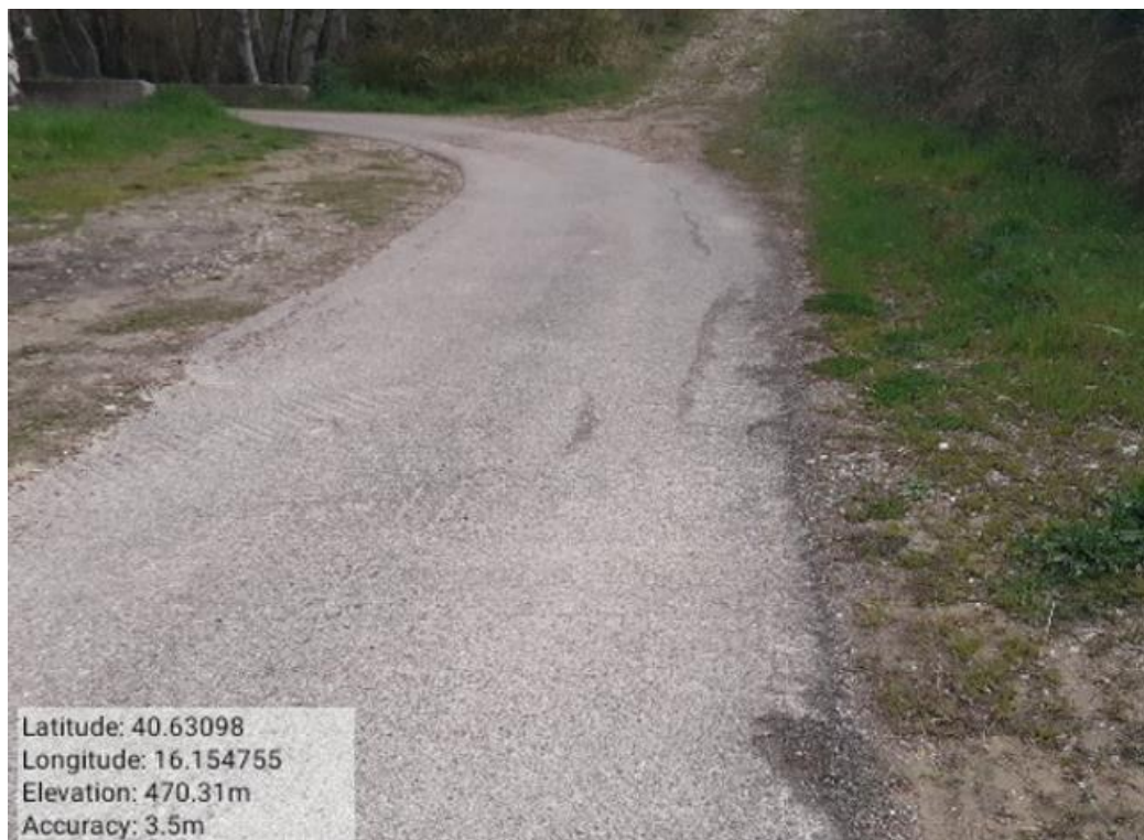
INTERVENTO 6.3.25 - TRICARICO STRADA COMUNALE CASTAGNONE 2 FG.61-48-37 Foto n. 65
