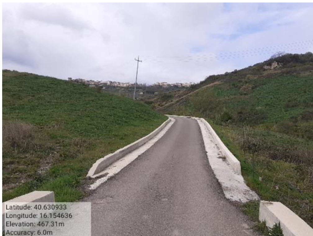
INTERVENTO 6.3.24.- TRICARICO STRADA COMUNALE CASTAGNONE FG.61-48-37 Foto n. 64
