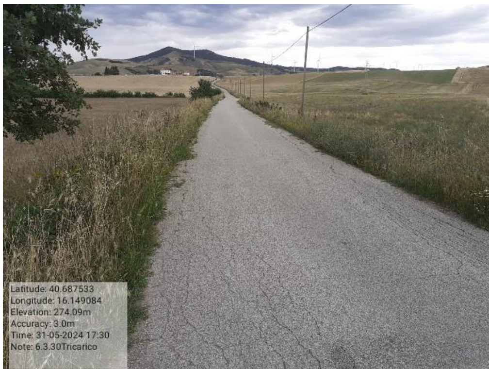
INTERVENTO 6.3.30.- TRICARICO STRADA COMUNALE SERRAMENTOLA ALTA FG5-8 Foto n. 70
