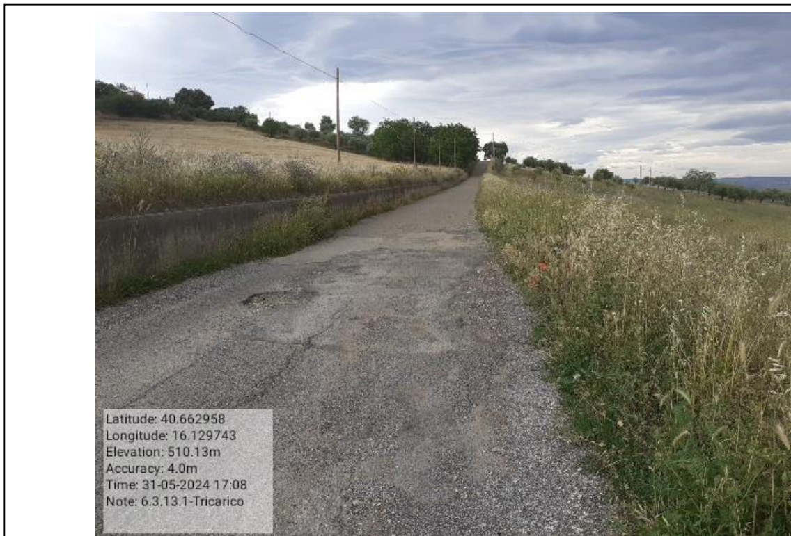
INTERVENTO 6.3.35 - TRICARICO STRADA COMUNALE TRIONTE FG19-19-20-31-32-42 Foto n.75
