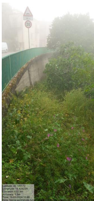
Int. Fascia Per. Antinc. Colobrarò - Foto1
